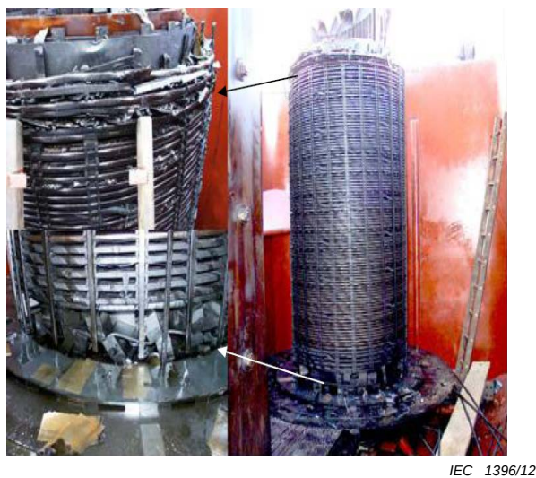
Figure B.19 – Réponse en fréquence d'un enroulement BT avant et après affaissement axial dû à un défaut de serrage avec une photographie du dommage [8]
